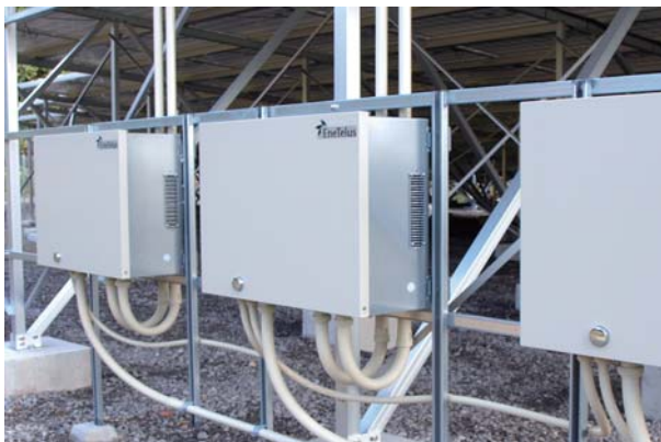
結線 パワコン設置
